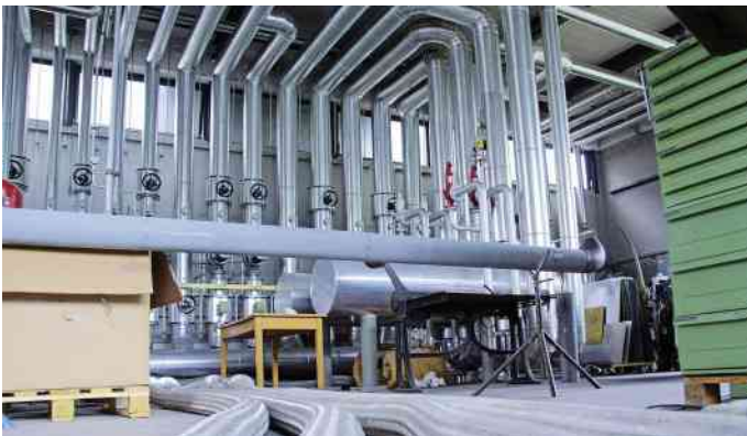
Einbindung mit betriebssicheren Panzerschläuchen DN 80 und DN 100 in die Wärmeverteilung.
