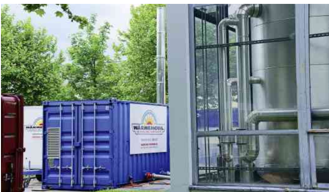
Optimale Platzverhältnisse für die Wärmemobil-Einheiten auf dem Waffenplatz.
